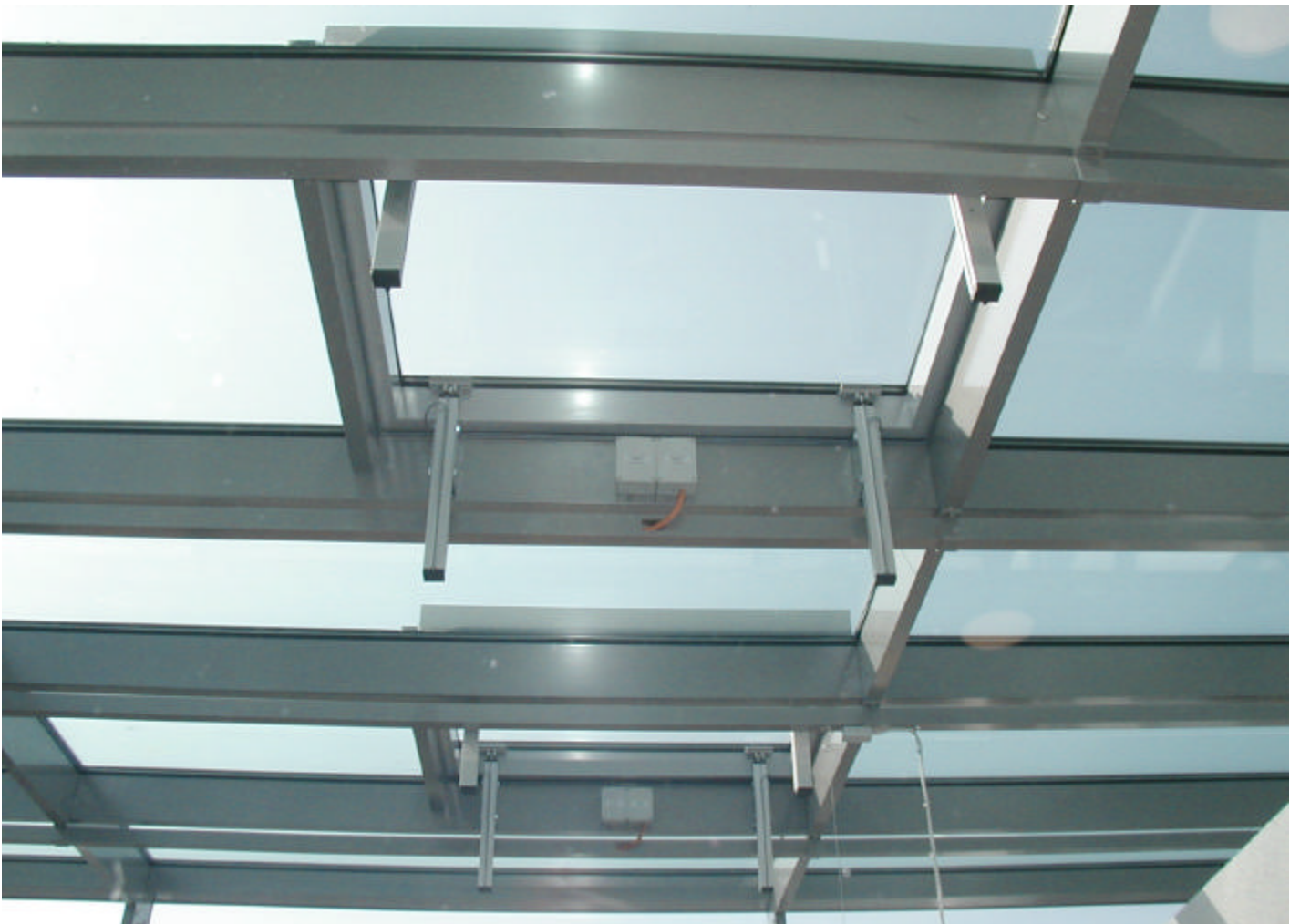
16 RWA-Hubflügel mit WERO RWA-Antrieben 24 V DC im 4-fach Synchronbetrieb
