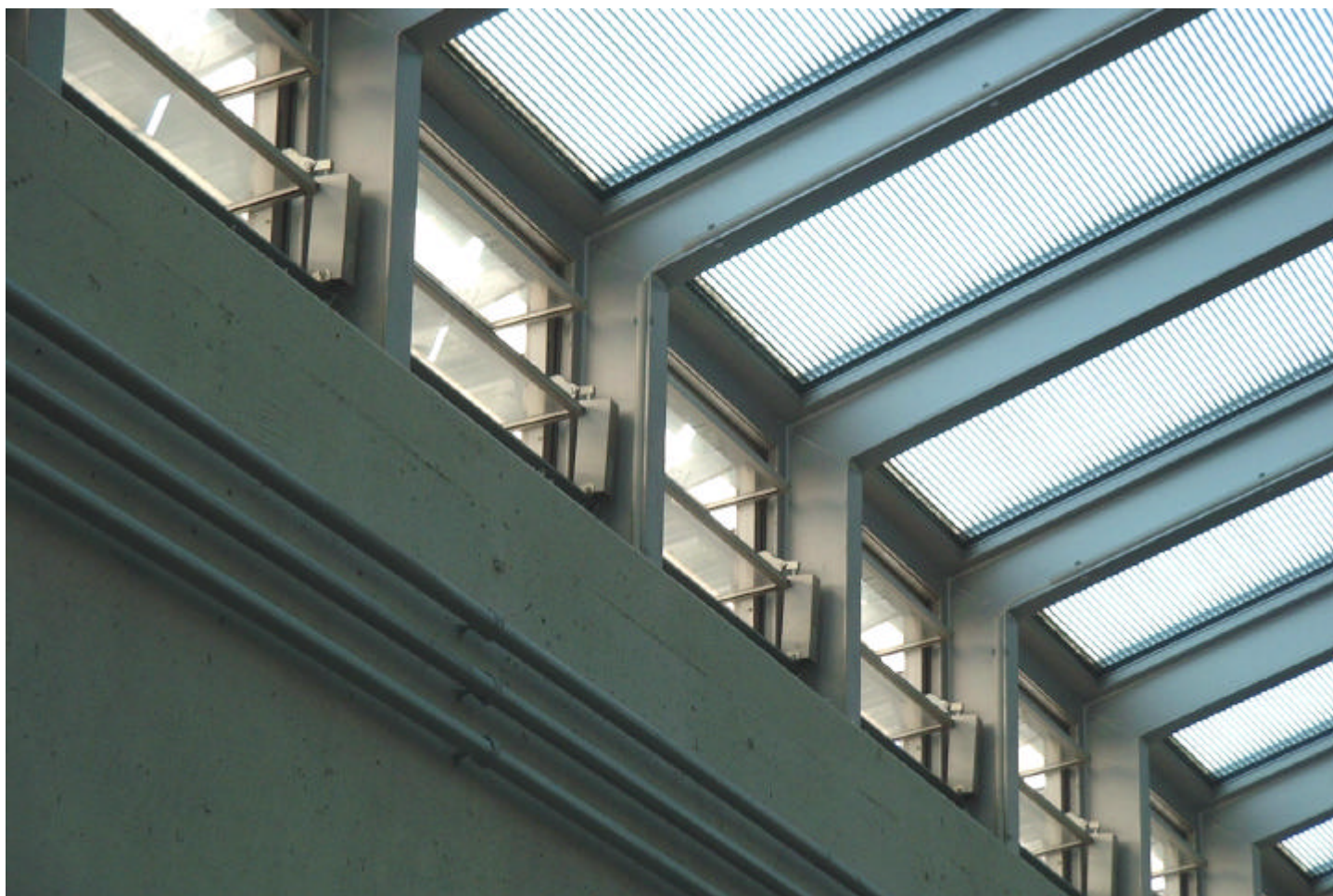
30 RWA- und Belüftungsanlagen mit insgesamt ca. 180 RWA-Öffnungslamellen / 90° Öffnungswinkel
