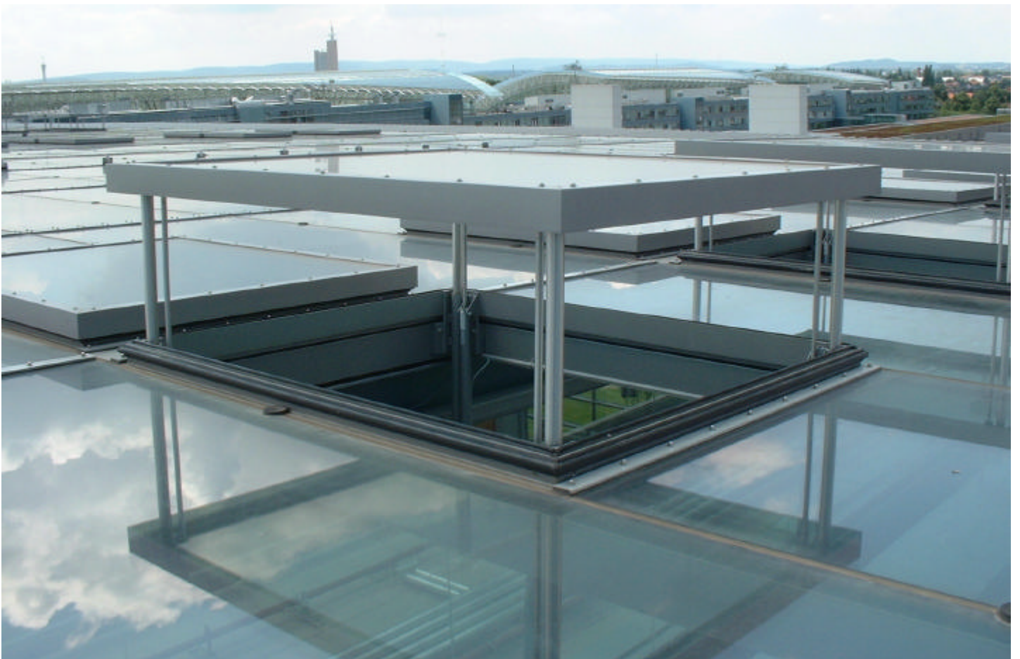
115 Dach-Hubflügel / Öffnung 500 mm gem. Brandsschutzgutachten HHP Braunschweig
