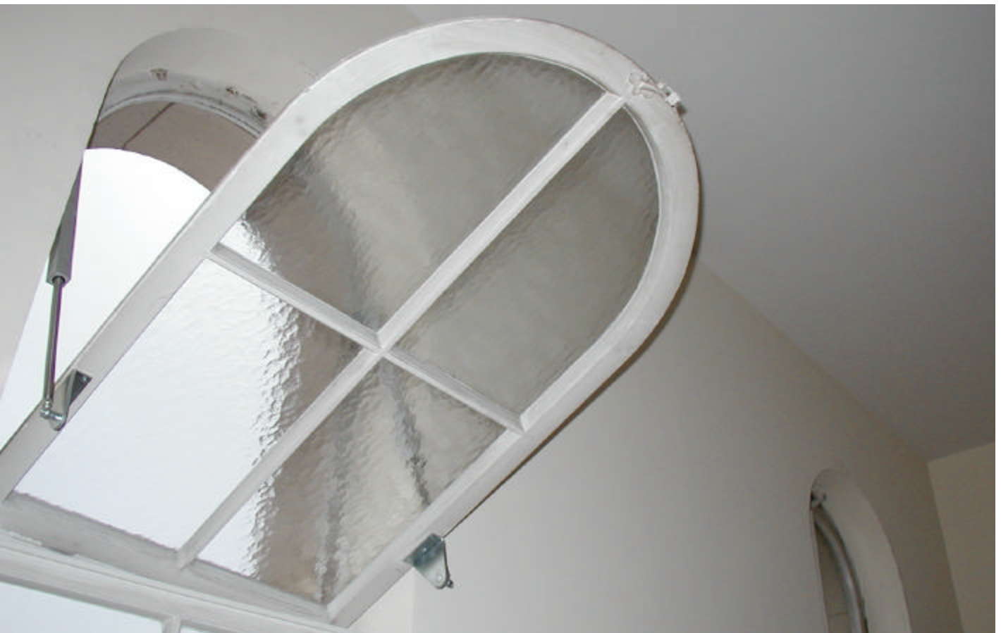
12 RWA- und Belüftungsanlagen mit jeweils 2 RWA-Antrieben am Flügel (Bestand/Altbau)
