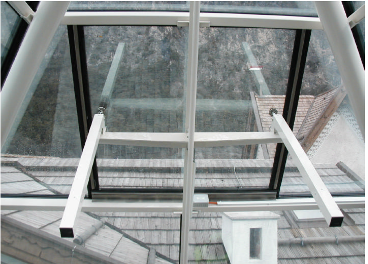
RWA-Flügel „Ganzglas“ in Glaspysramiden Betätigung über Synchronantriebe SG 150 (1500 N pro Antrieb) Öffnungsweite 800 mm gem. Brandschutzgutachten
